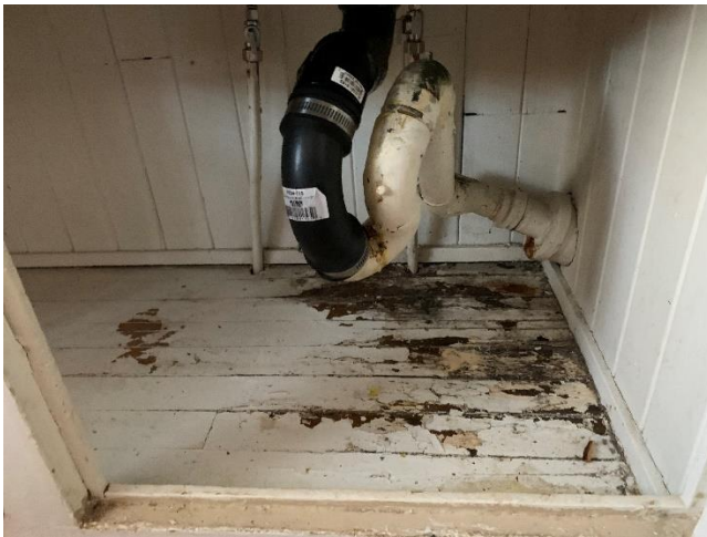
Dessous du lavabo de cuisine
